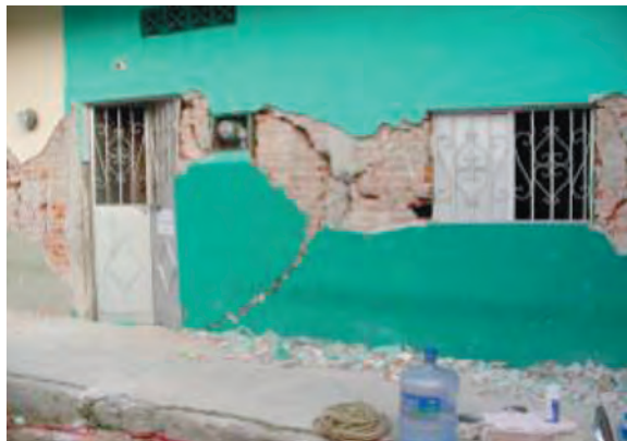
a) Daño severo en Villa de Álvarez
