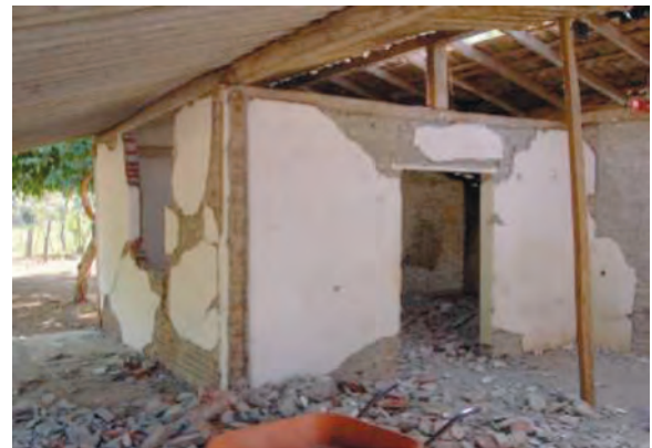
b) Daños en mampostería simple
