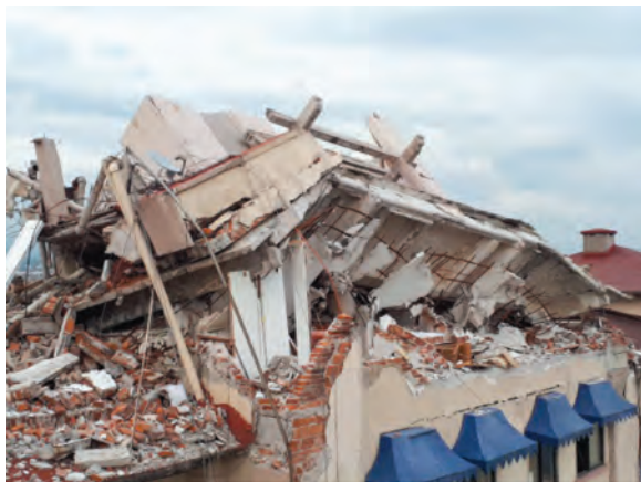
a) Daños en un edificio en Cuernavaca
