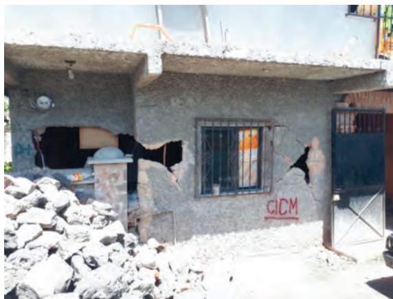
b) Colapso de muro de carga
