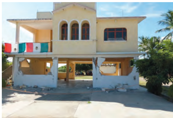
b) Casa de mampostería con grandes aberturas
