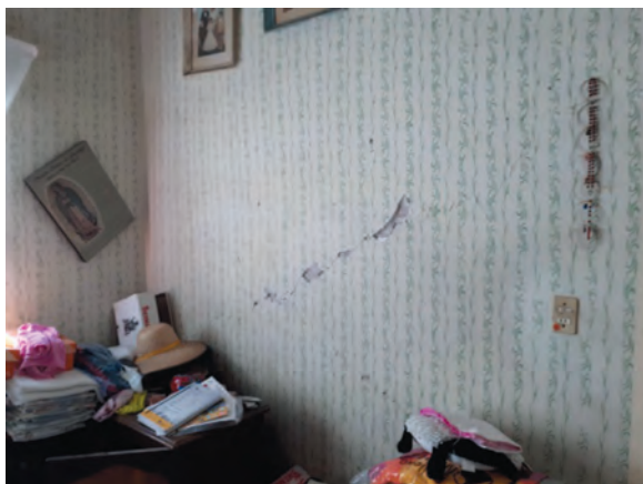
a) Daño medio en muro de carga
